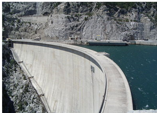
Figure 1: O dimensionamento de uma barragem requer que o engenheiro saiba determinar as forças hidrostáticas que atuam na superfície submersa associada à distribuição de pressão não uniforme atuante ao longo da parede em contato com o fluido represado
